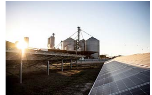
設置されている太陽光発電パネル
