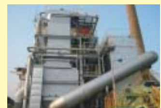
バイオマス燃料を使用するボイラー設備設置例
