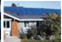
住宅用発電設備設置例
