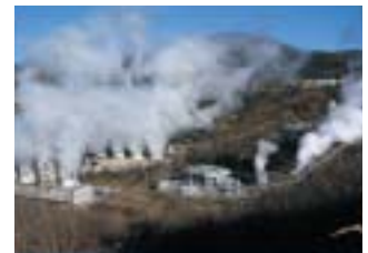
九州電力株式会社 八丁原バイナリー発電設備(2,000kw)
