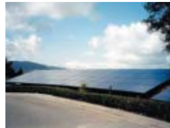
住宅用大型発電設備設置例
