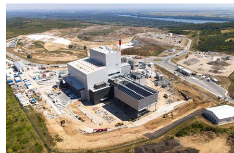
(建設中 (一部運営中) のセルビア/ベオグラード廃棄物処理・発電 PPP 事業)
