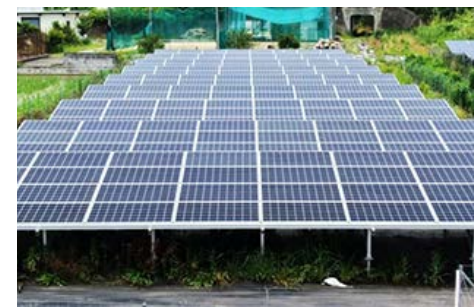
クリーンエネルギーコネクト オフサイト型分散電源
