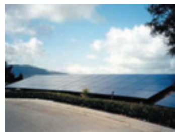
住宅用大型发电设备设置实例
