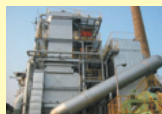
使用生物质燃料的锅炉设备安装实例
