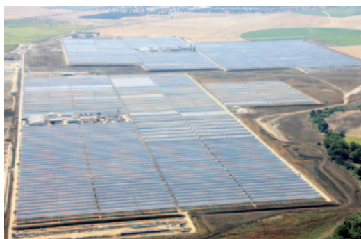
Abengoa公司经营的相同规模的发电站(该公司提供)
