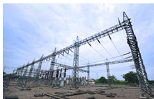
加拉璜工业园专用的变电站
