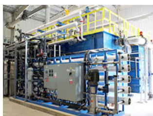
厂区内的污水处理设施
