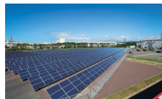
设于三国工场占地面积内闲置用地的 太阳能面板
