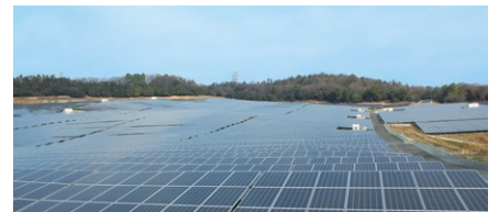
新冈山太阳能发电站（2017年1月，投入商业运转）
