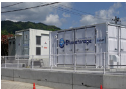
用于电网系统的大型蓄电池
