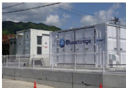
用于电网系统的大型蓄电池
