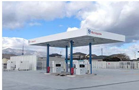
2024年5月に開業したエア・リキード本宮インターチェンジ水素ステーション
