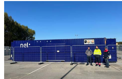
グリーン水素の製造装置
