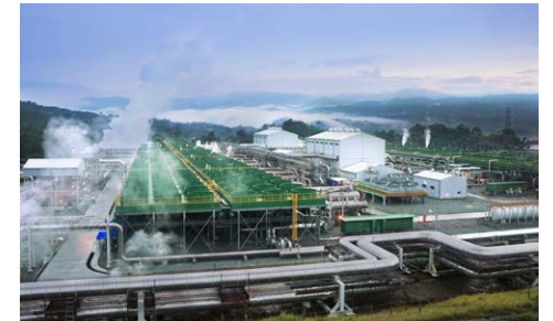
Sarulla 地熱発電所写真 (2・3号機)
