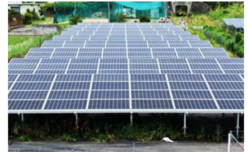
クリーンエナジーコネクトが運営するオフサイト型分散電源
