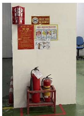
(消火設備の分かりやすい設置)
