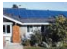
住宅用発電設備設置例
