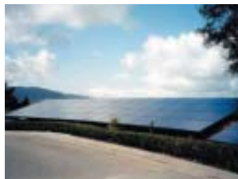
住宅用大型発電設備設置例
