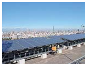
東京本社ビル 屋上に設置された太陽光パネル
