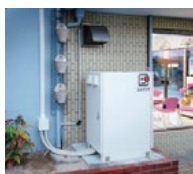
蓄電池設置事例
