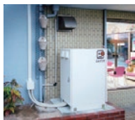
蓄電池設置事例
