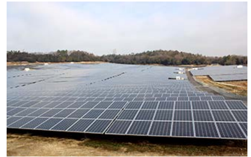
新岡山太陽光発電所
