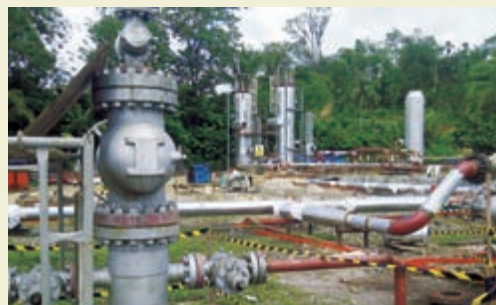
サルレー地熱発電所の噴気試験設備
