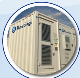
発電・蓄電所
