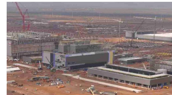
半導体製造工場
