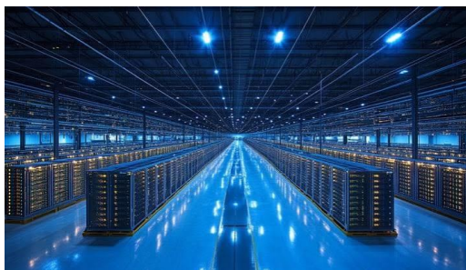
データセンター
