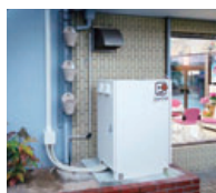
蓄電池設置事例
