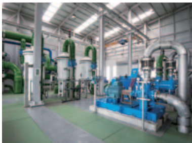
グラン・カナリア島にある海水淡水化プラント
