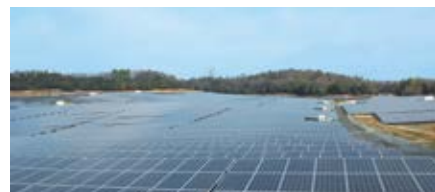
新岡山太陽光発電所 （2017年1月、商用運転開始）
