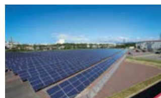
三国工場敷地内遊休地に設置した ソーラーパネル
