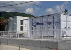
系統用大型蓄電池
