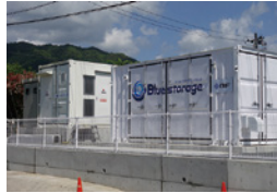
系統用大型蓄電池
