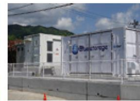
系統用大型蓄電池
