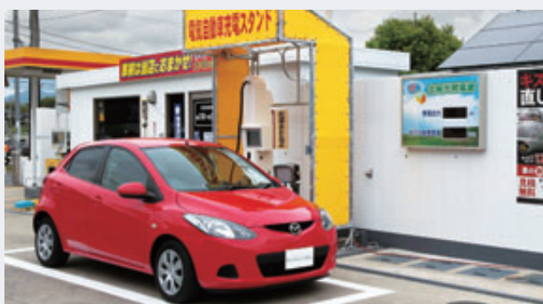
開発戦略室：伊藤忠エネクス学園東大通りCS店（ガソリンスタンド）に設置した急速充電器とカーシェアリング用途として配備した電気自動車
