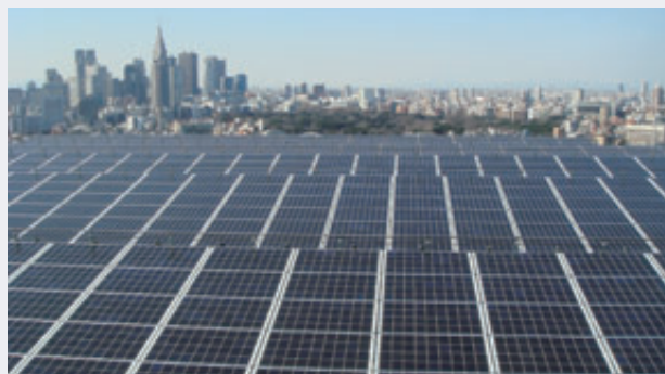
ソーラー事業推進部：伊藤忠商事東京本社ソーラー発電所
